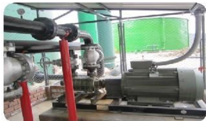
Estación de bombeo
