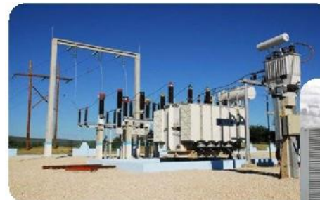
Punto de energía eléctrica cercana a la estación de bombeo
