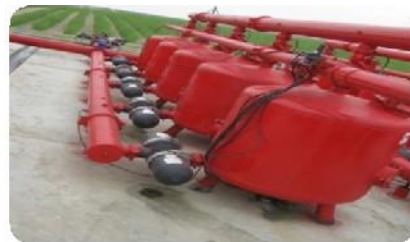
Sistema de Filtrado
